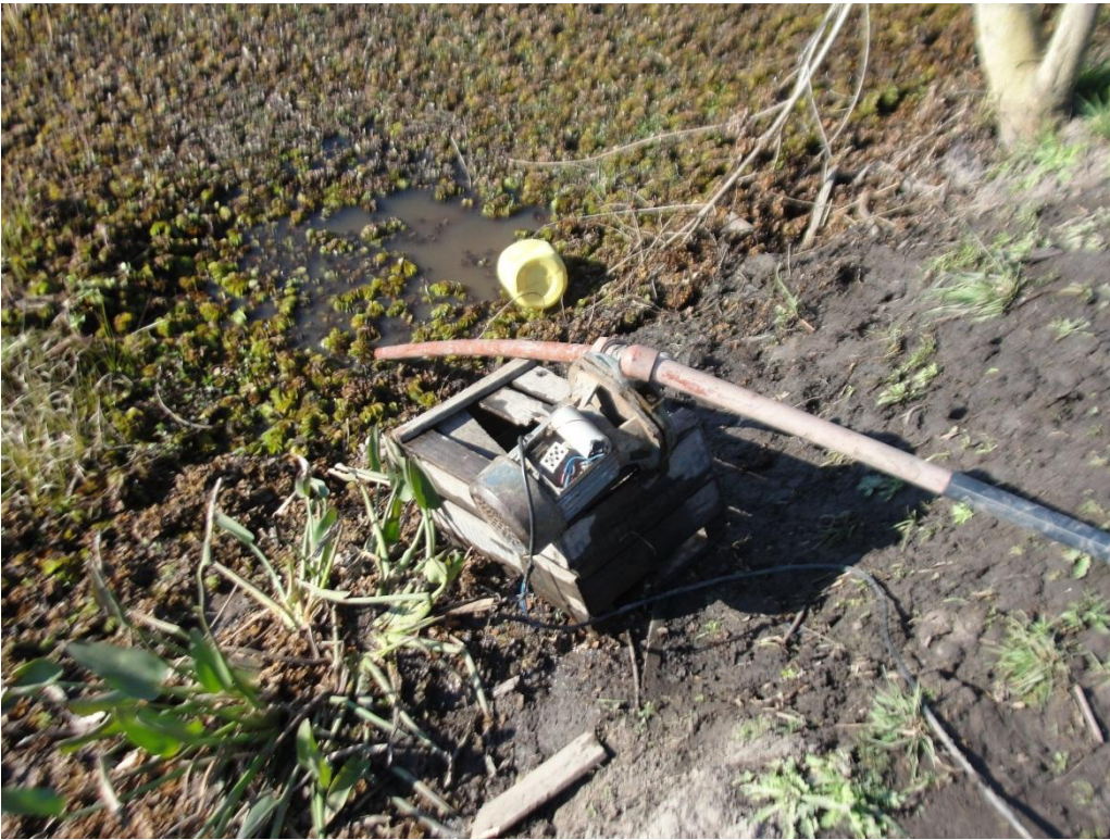
Bomba de riego
